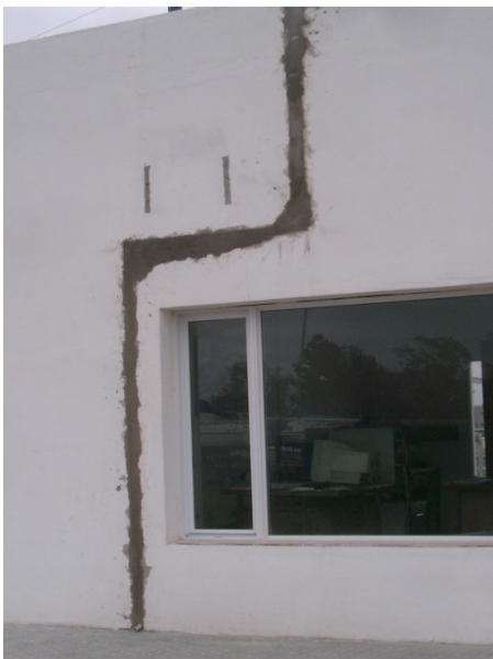
Secretaría: Se embutieron los caños de gas y de descarga de agua del aire acondicionado
